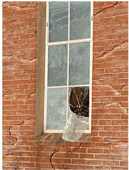
Fabrieksmuur Hartenseweg Renkum Herstel vandalisme blijft achterwege.
